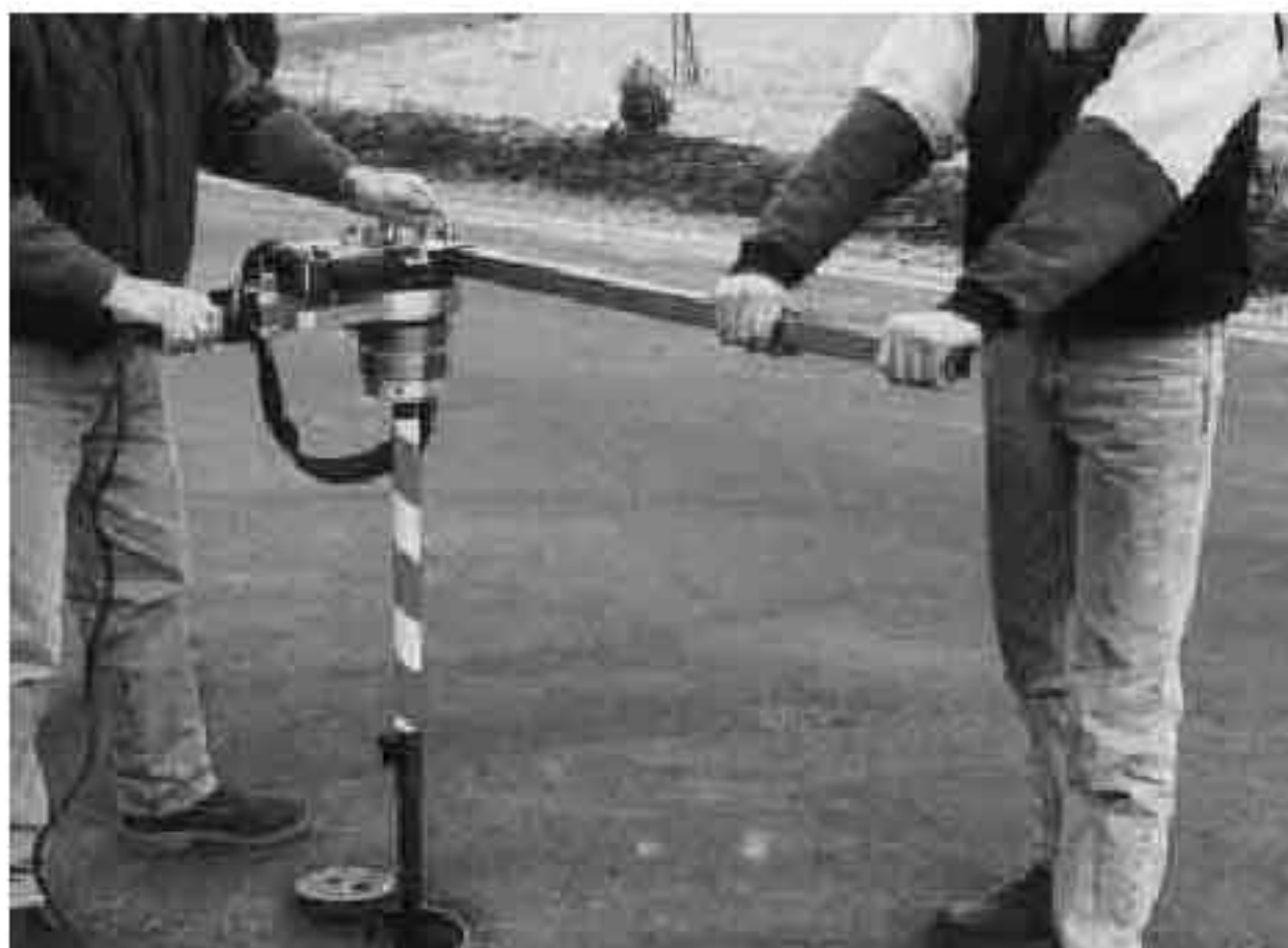
باز و بسته نمودن شیرهایی که زیر زمینی نصب شده اند (شکل ۱)
