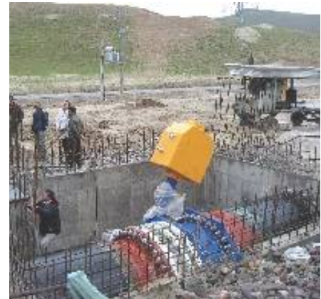
شیر سایز 1800 فشار 25 بار - نرمال باز کاربرد: کنترل پمپ و شکستگی خط پروژه: سد دوستی خراسان رضوی
